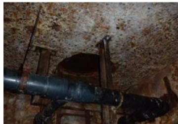
① 着工前(劣化状況)
